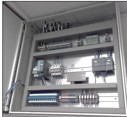
Der neue Schaltschrank. Digitale Technik für das 45 Jahre alte Glockenspiel.
